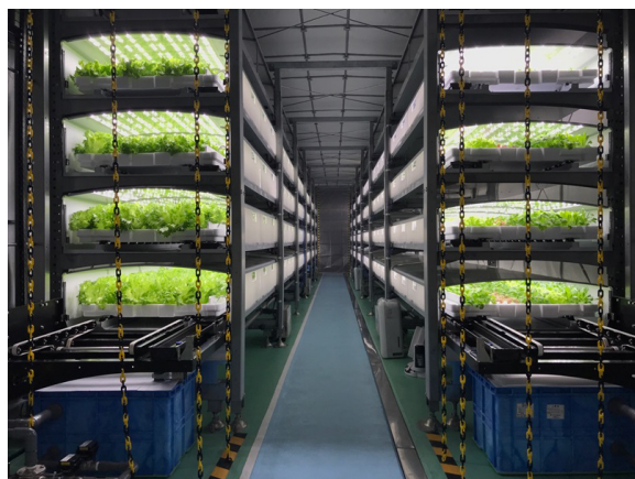
写真8 セル式モジュール型植物工場
