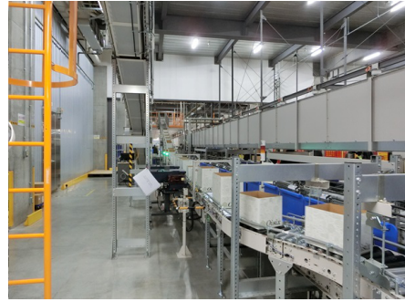
写真7 段ボールケースを無線表示器とRFIDを搭載したトレーに移載
